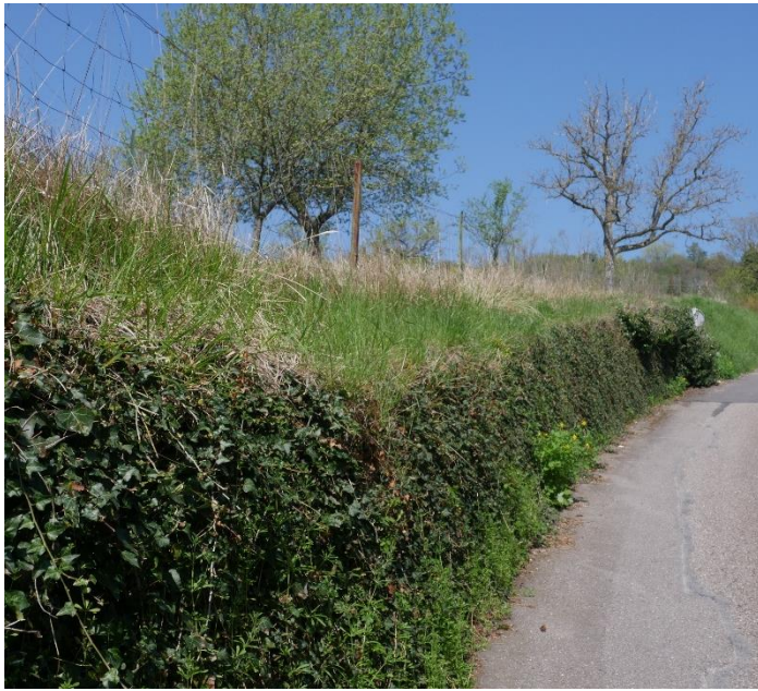
Figure 19 : MPS entièrement recouvert par le lierre
